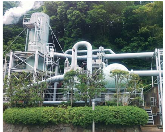
杉乃井地熱発電所
