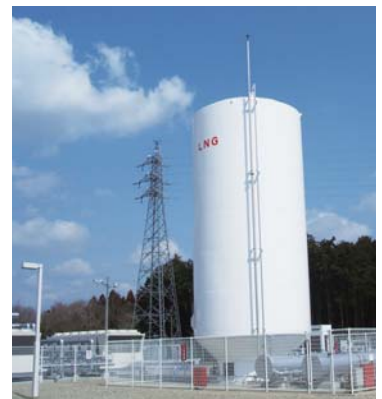
本社工場に導入したLNGサテライトタンク
