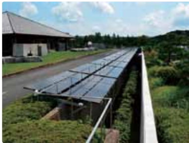
「奈良若草カントリー倶楽部」のクラブハウス前に100mにわたり設置された太陽光パネル
