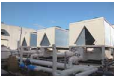
西神戸工場に導入した空調機器
