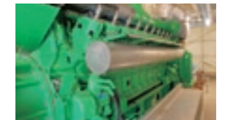
ガスエンジン(ガスタービンとの併用運転により高効率発電を実現、最大8,000kWの余剰電力を生み出しています)
