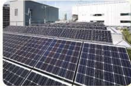
上野一丁目ビル太陽光発電システム
