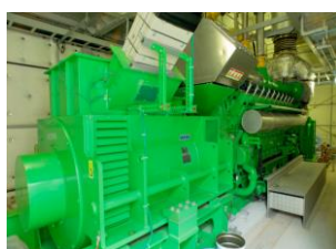
ガスエンジン
