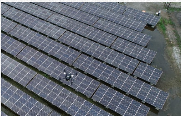
ドローン空撮業者の全国ネットワークも構築済み
