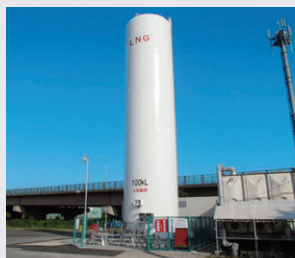
北海道工場に導入した LNGサテライトタンク
