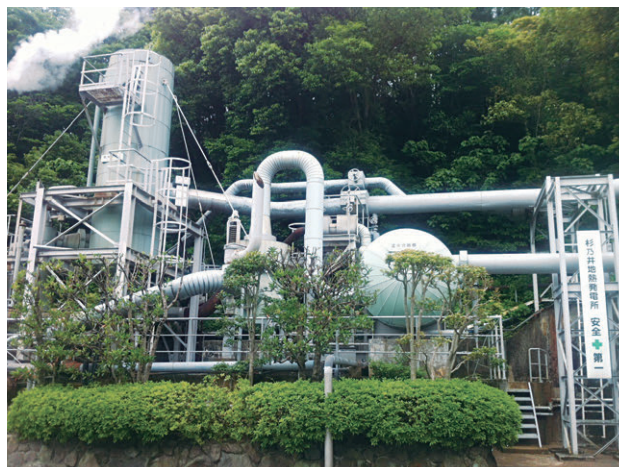
杉乃井地熱発電所
