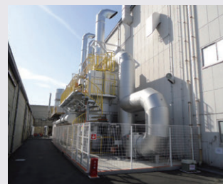
上田工場東京製造所に導入した VOC処理装置(蓄熱燃焼脱臭装置)
