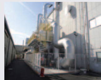
上田工場東京製造所に導入した VOC処理装置(蓄熱燃焼脱臭装置)
