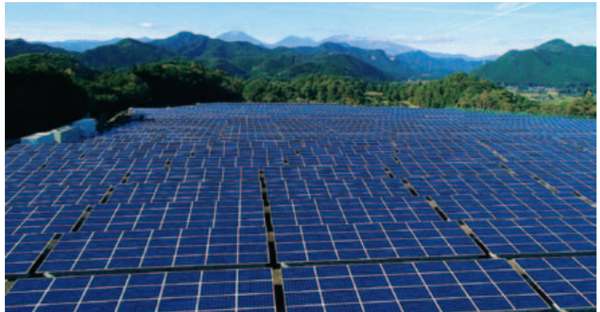
ディアレイク・カントリー倶楽部メガソーラー発電所 (栃木県鹿沼市)
