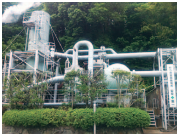
杉乃井地熱発電所
