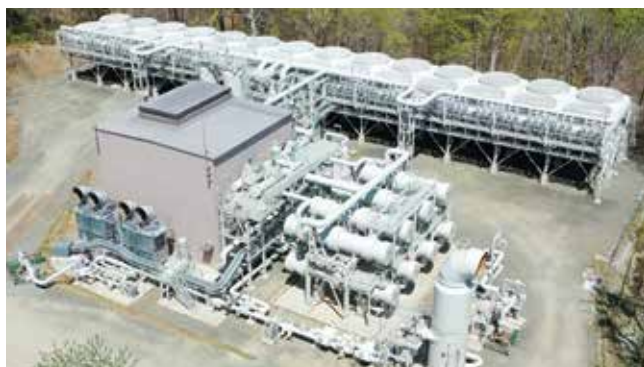
南茅部地熱発電所
