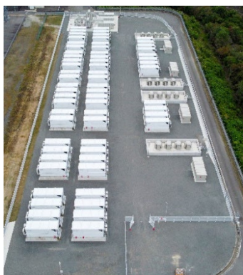
「紀の川蓄電所」 全景
