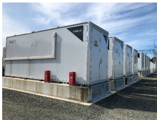
蓄電池コンテナ
