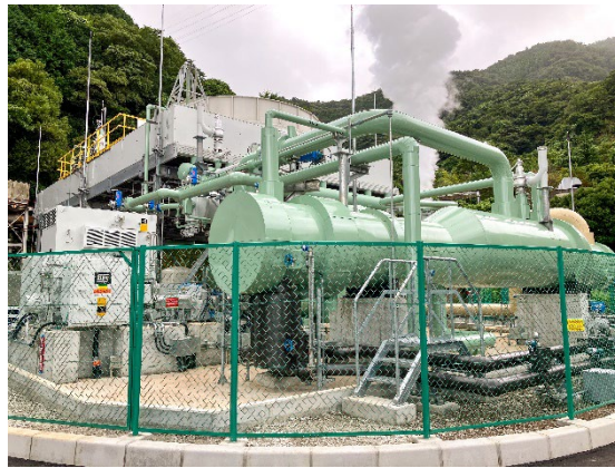
「杉乃井地熱発電所」
